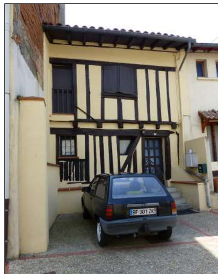
Façade en pans de bois 17e siècle, banalisée par l'apport d'un crépi inadapté et le traitement trop sombre des bois
