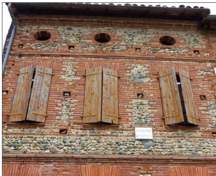
maçonnerie mixte apparente, destinée primitivement à recevoir un enduit
