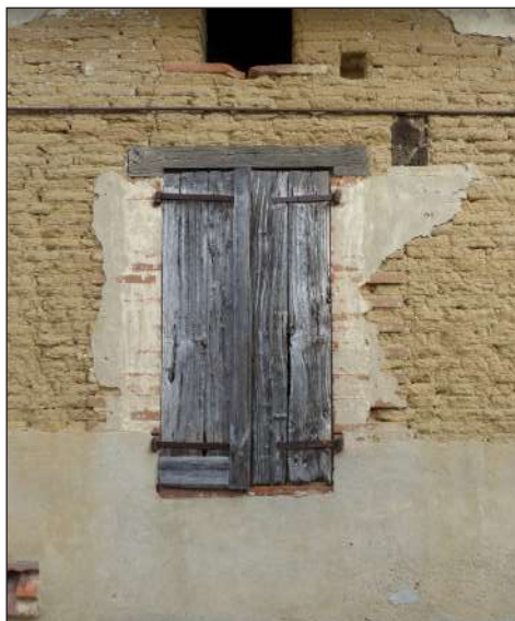
vestiges d'enduit sur parement de briques crues
